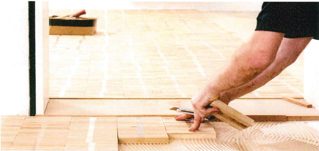
Wehe, wenn der Kleber versagt: Kosten, die infolge mangelhafter Bauprodukte entstehen, bleiben am Handwerker hängen
